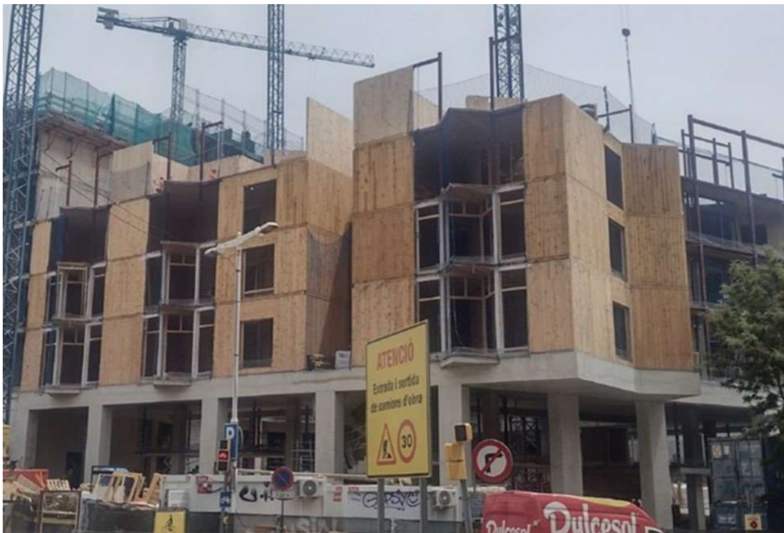
Montaxe de estrutura de CLT de piñeiro galego na promoción Illa Glòries, Barcelona – IHAMB Instituto Municipal do Habitat e a Rehabilitación do Concello de Barcelona (2023) | Certo estudio | Fotografía: Álvaro López
