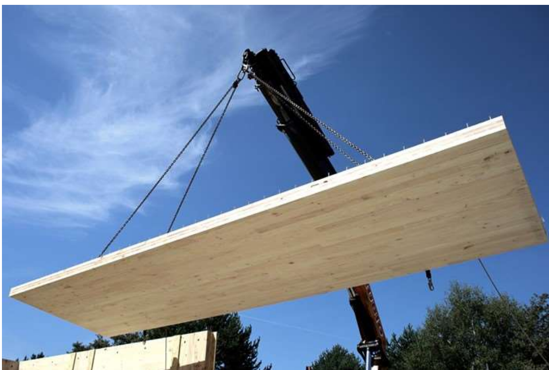
Montaxe da estrutura de CLT de piñeiro galego da Base de Unidade Operativa (BUO) de Muíños (Ourense) - - Consellería do Medio Rural da Xunta de Galicia (2023) | MOLA Arquitectura | Fotografía: Manuel Touza
